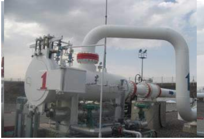
Şekil 3. Filtreleme Sistemi (Siklon ve Ayırıcı-Separatör Filtreleri)
