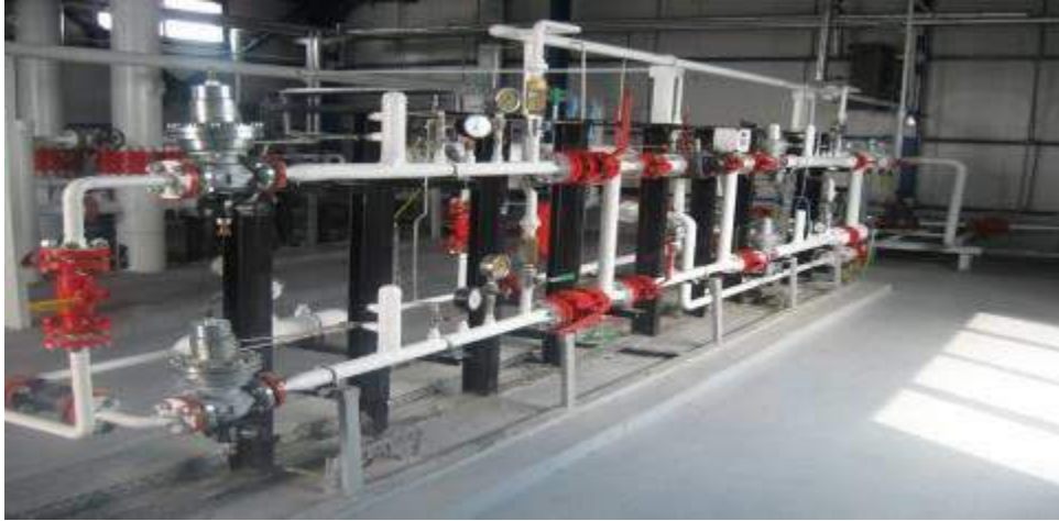
Şekil 11. Yardımcı Binalar Gaz Skid
