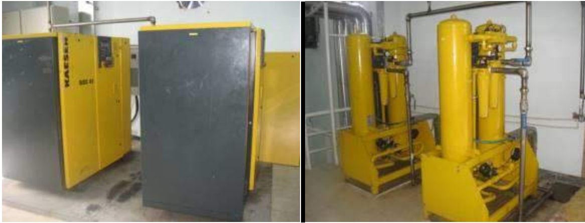
Şekil 12.Hava Kompresörleri ve Hava Kurutucuları
