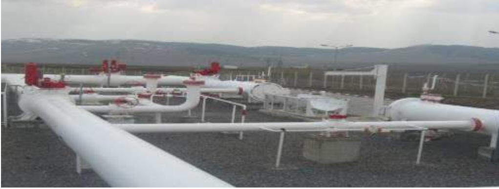
Şekil 2. İstasyon Giriş ve Çıkış, Pig Alma ve Atma İstasyonu, Bypass Sistemi
